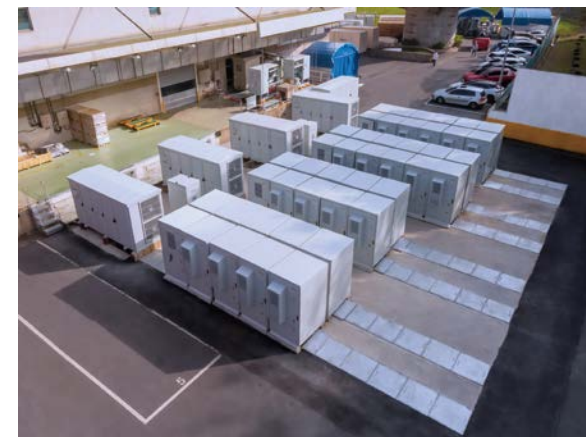
圖3. 16MW測試平台
